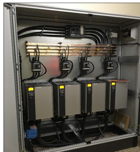
Création d'une Armoire Variateur Pompes
