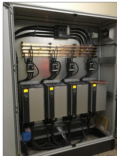
Création d'une Armoire Variateur Pompes
