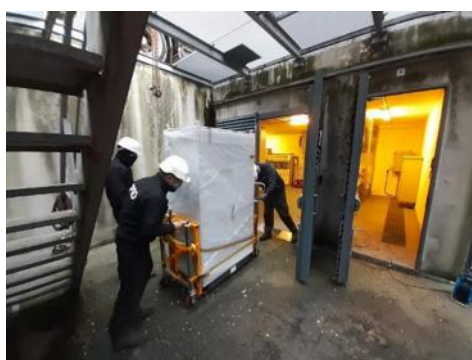
Changement onduleur SSR4
