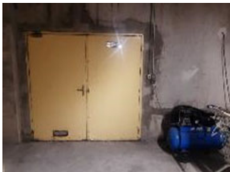
Porte en bois avant remplacement
